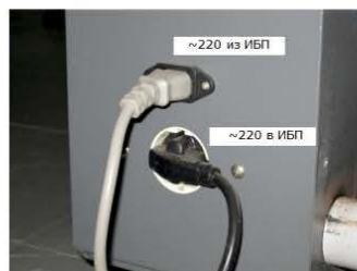
5. Блок подключения ИБП
