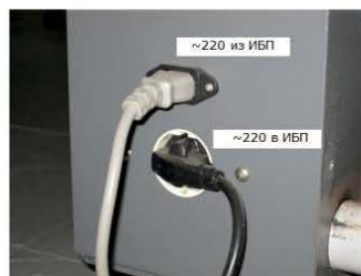
5. Блок подключения ИБП
