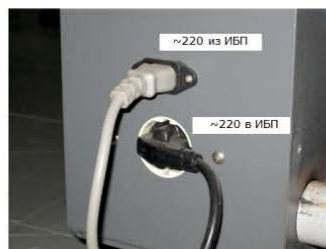
5. Блок подключения ИБП
